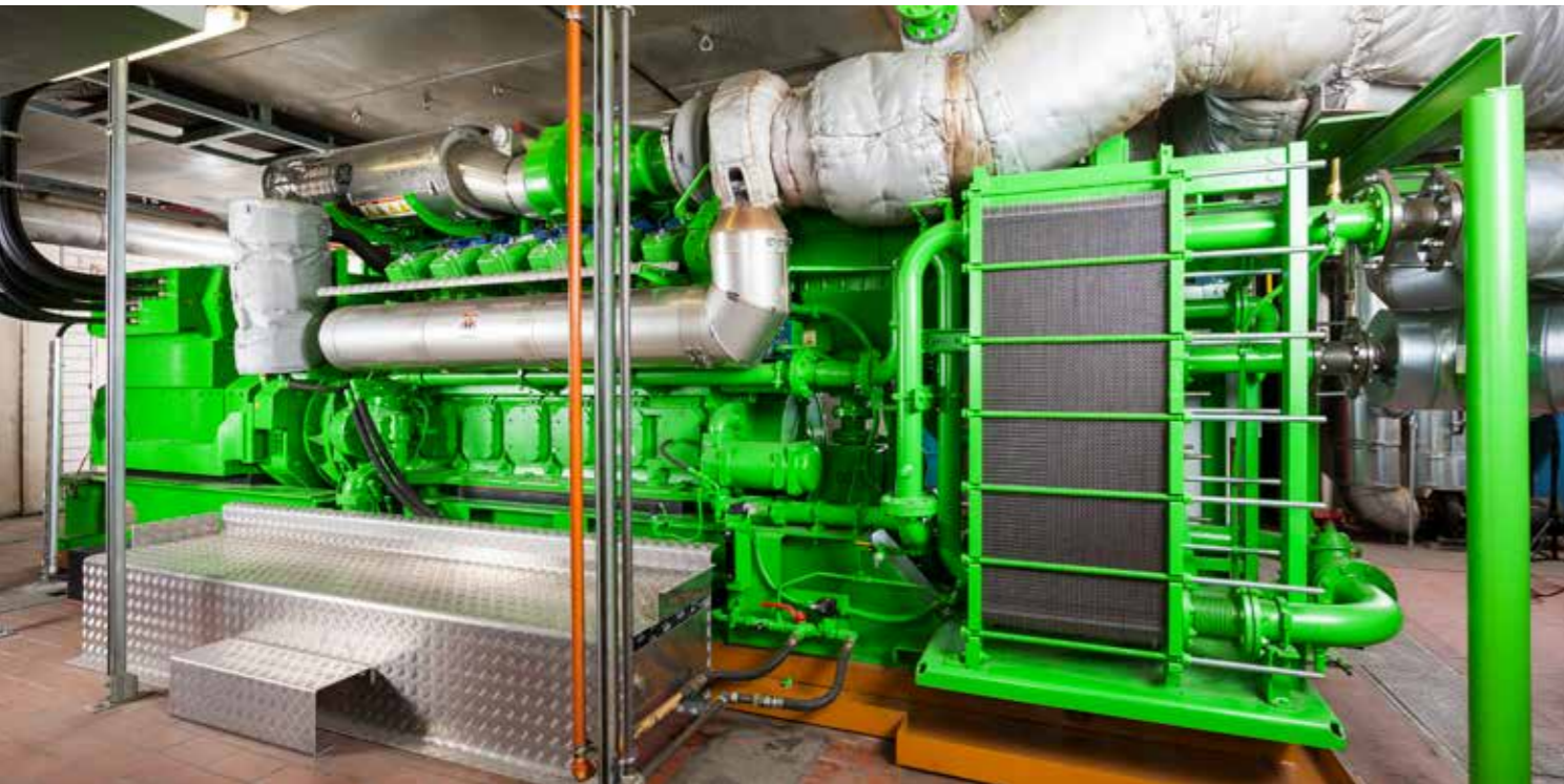
Das Heizkraftwerk Teurershof zählt zu den größten Kraftwerksanlagen des Versorgungsunternehmens. Für den sicheren Betrieb ist die Abteilung Kraftwerke/Wärmeverteilung zuständig.
