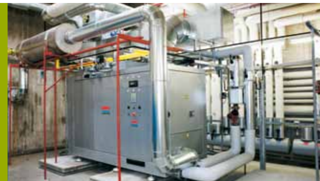
BHKW Schulzentrum West
