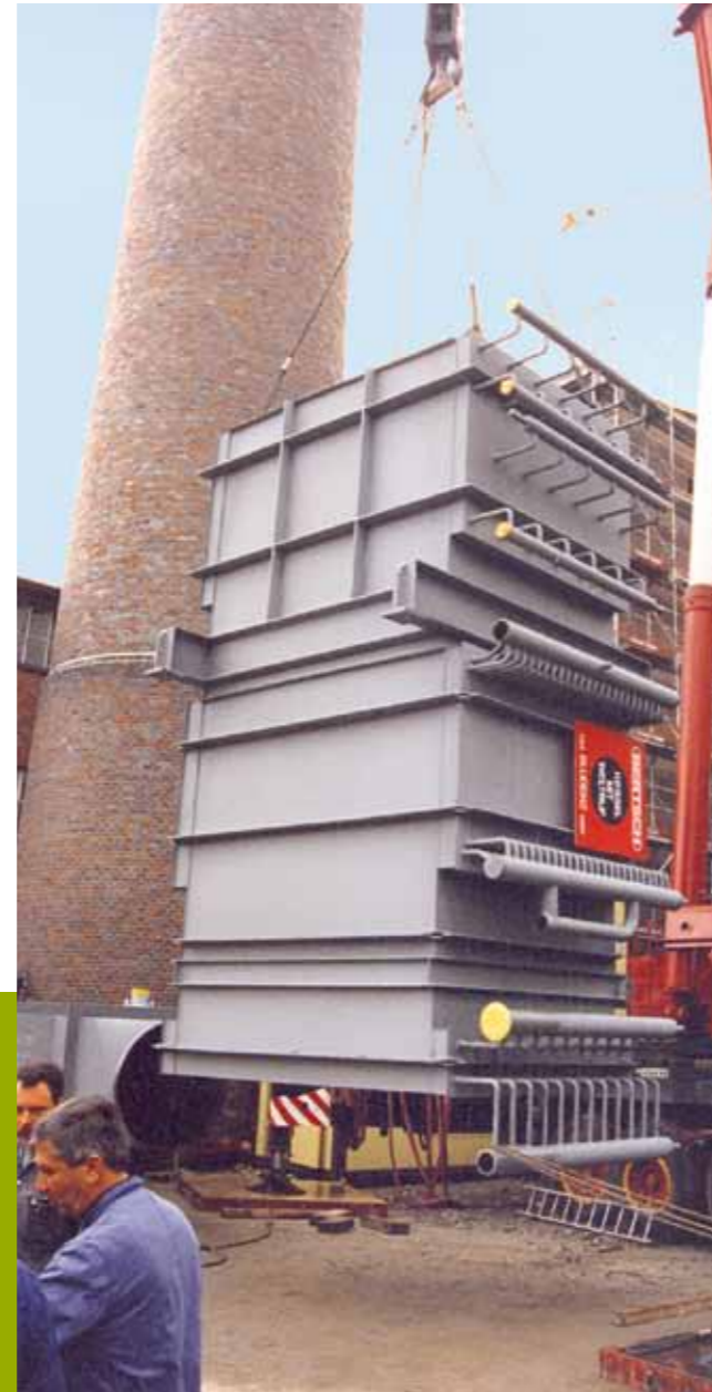
Gas- und Dampfturbinenkraftwerk Salinenstraße, 1994
