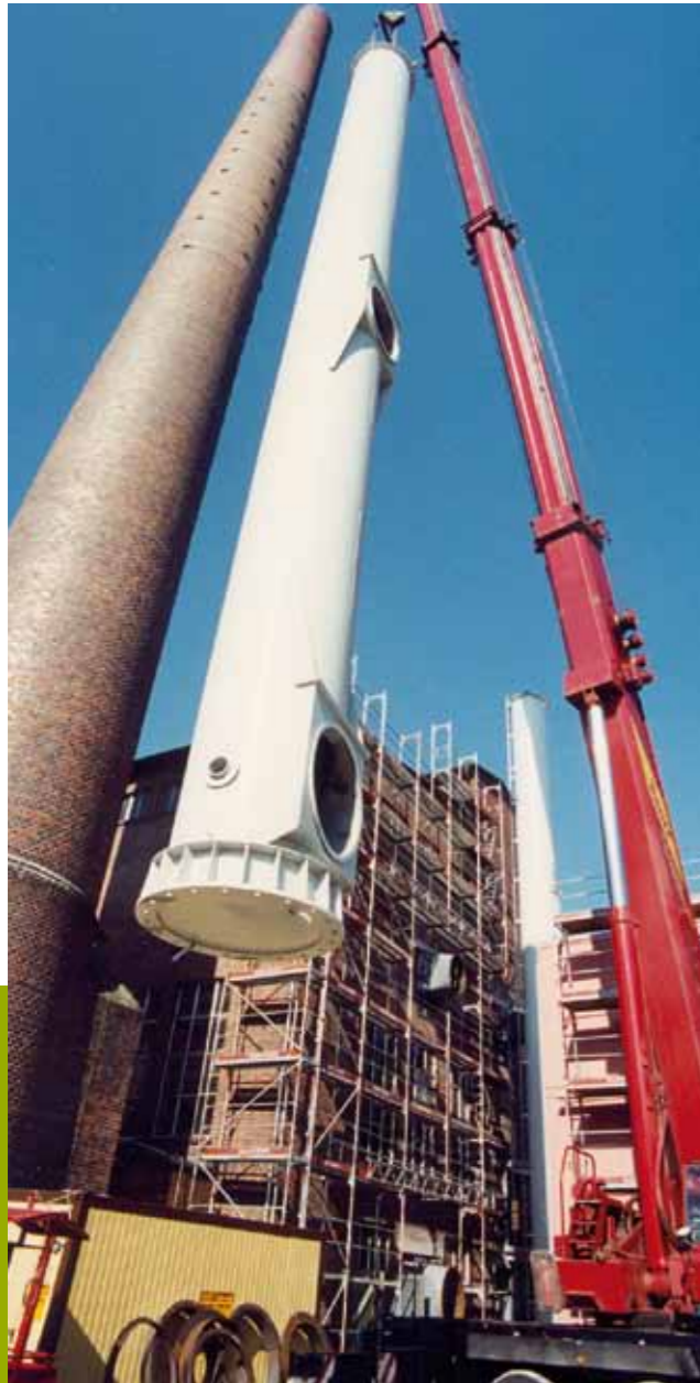
Gas- und Dampfturbinenkraftwerk Salinenstraße, 1994
