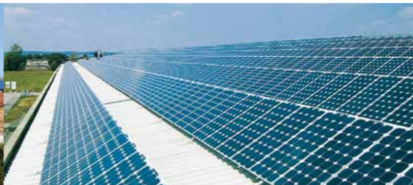
Photovoltaikanlage Hangar Solpark
