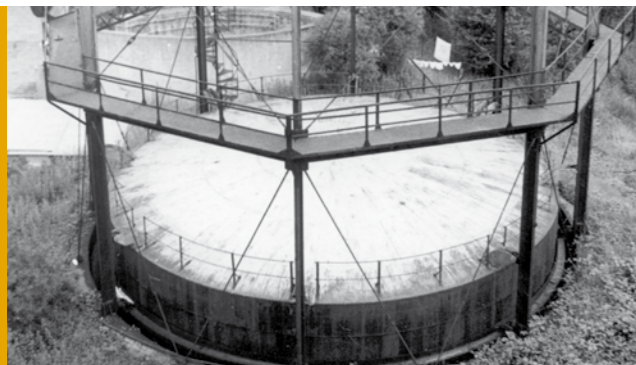
Gaspeicher, fast leer
