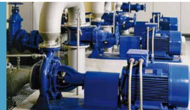
Förderanlage Wasserwerk Uttenhofen
