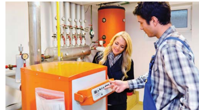
In einigen Heizungskellern stehen oft noch alte Geräte.
